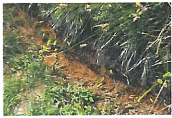
Vue de la fuite d'eau de couleur rouille
